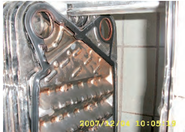
Abb. 11.2: Mangelhaftes Reinigungsergebnis an einem Plattenwärmeüberträger (Quelle LÜVA Freiberg)
