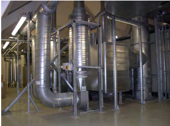
Abb. 9.1: Blick auf die Zentrale einer Klimaanlage, ihr komplexer Aufbau erfordert interdisziplinäre Kompetenz sowohl von technischer als auch von hygienischer Seite
