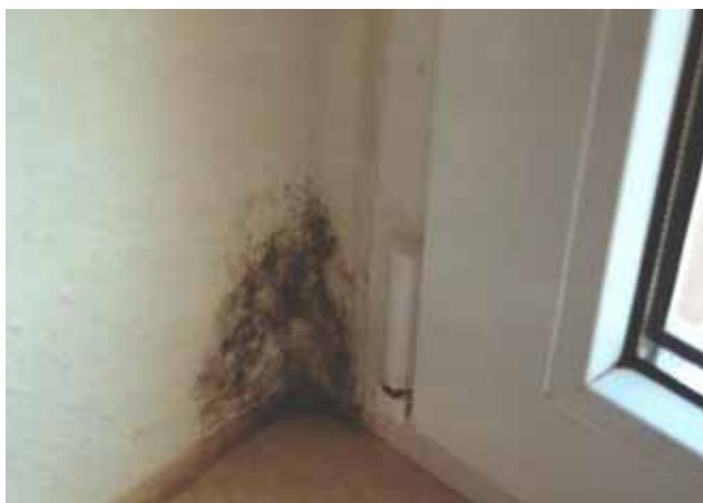
Abb. 9.4: sichtbarer Schimmelpilzbefall im Innenraum
